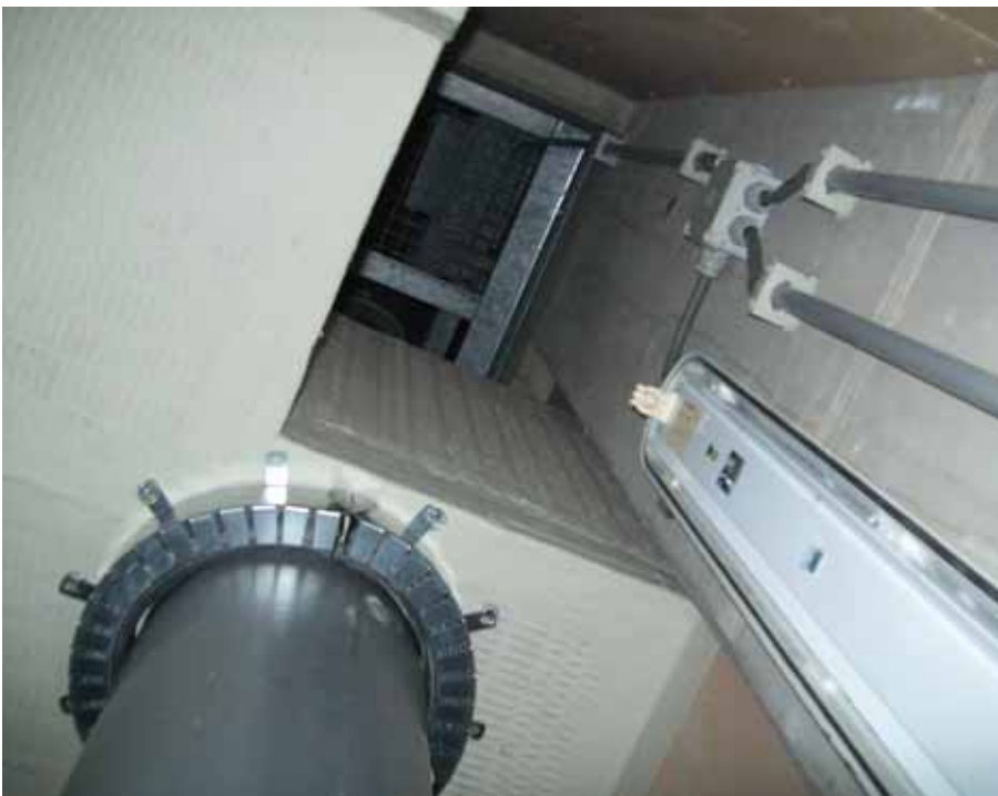
Zijn doorvoeringen potentieel zwakke schakels in brand- en rookscheidende wanden?
